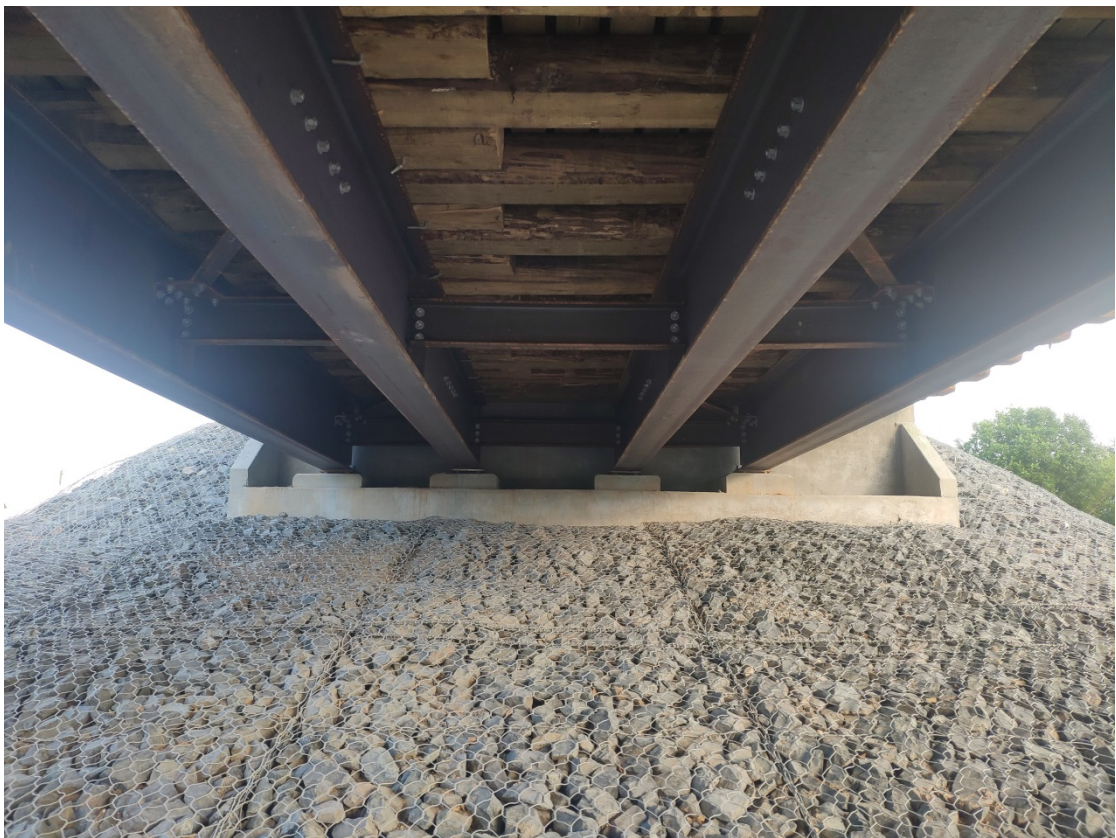
Рисунок 7 – Общий вид на опору №4 и ПС№3
