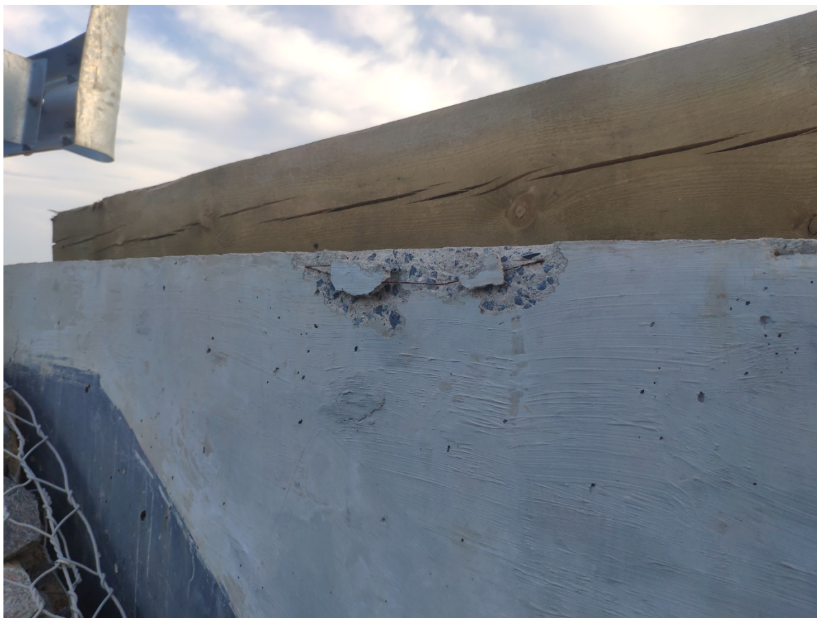
Рисунок Б12 – Механический скол и раковины на бетонной на правом открылке опоры №4
