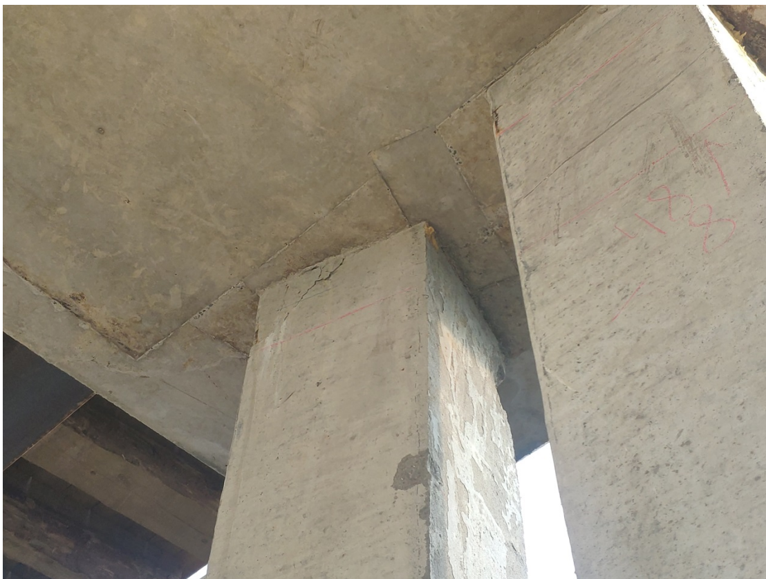
Рисунок Б10 – Смещение по горизонтальной оси стоек опоры №2, силовой скол
