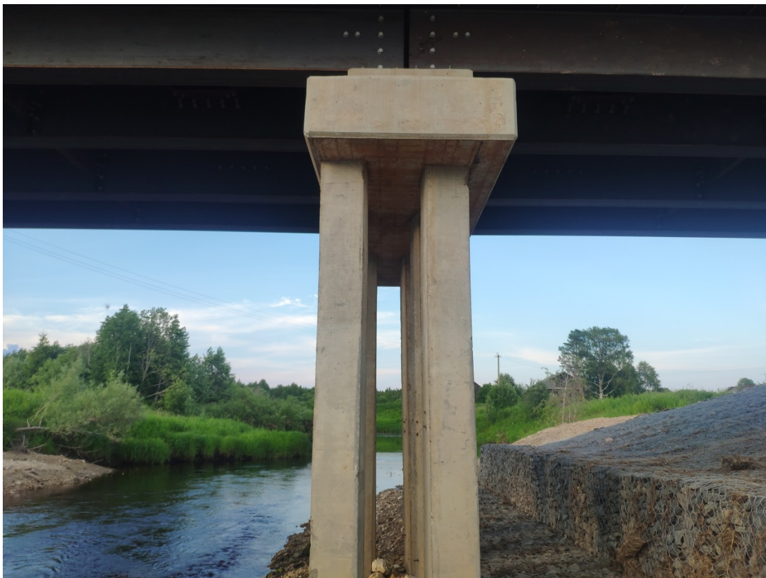
Рисунок Б9 – Смещение по вертикальной оси и в плане стоек опоры №3
