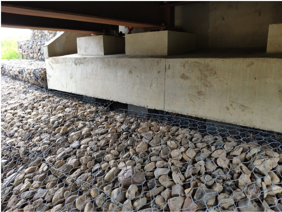
Рисунок Б26 –Просадка укреплений, опора №1
