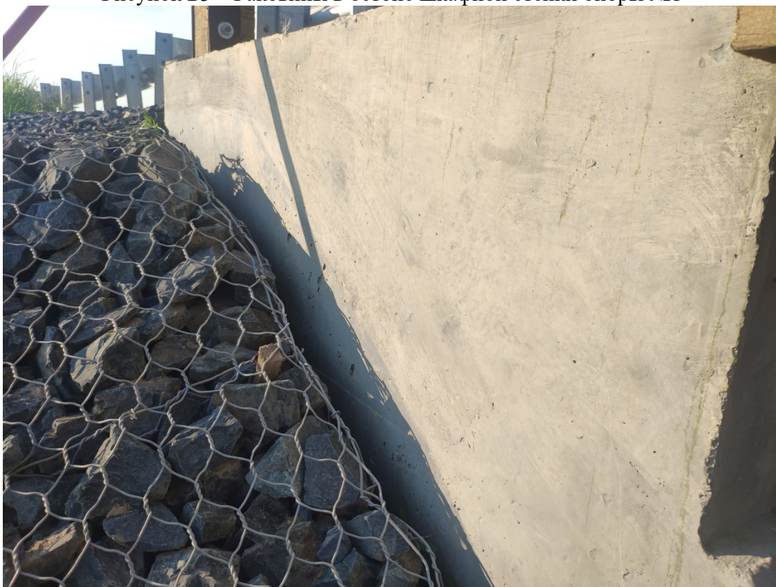
Рисунок Б4 – Раковины в бетоне правого открьлка опоры №1
