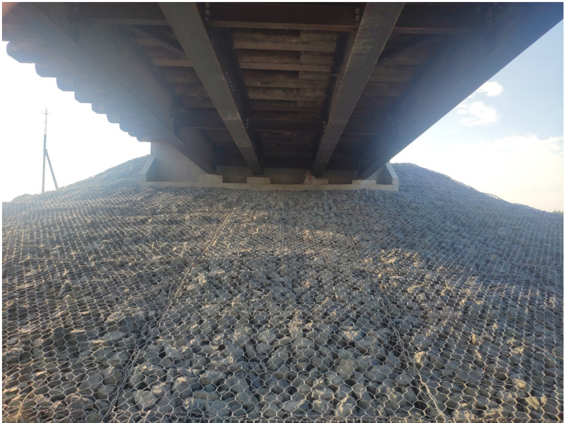
Рисунок 5 – Общий вид на опору №1 и ПС№1
