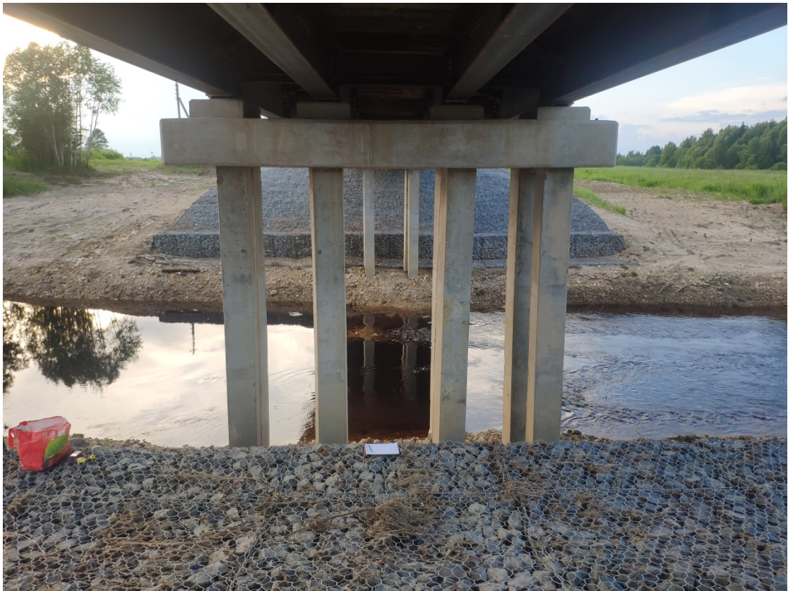
Рисунок 7 – Общий вид на опору №3 и ПС№№2-3
