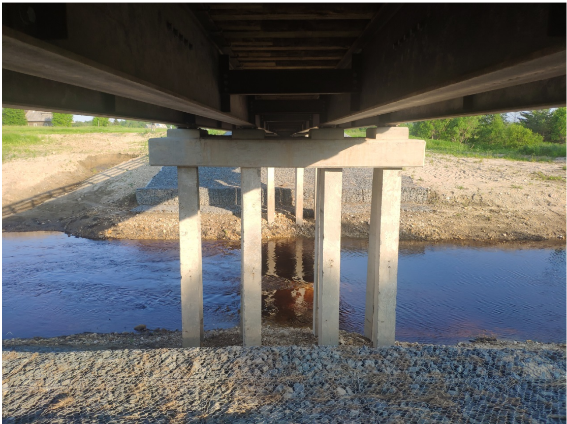
Рисунок 6 – Общий вид на опору №2 и ПС№№1-2
