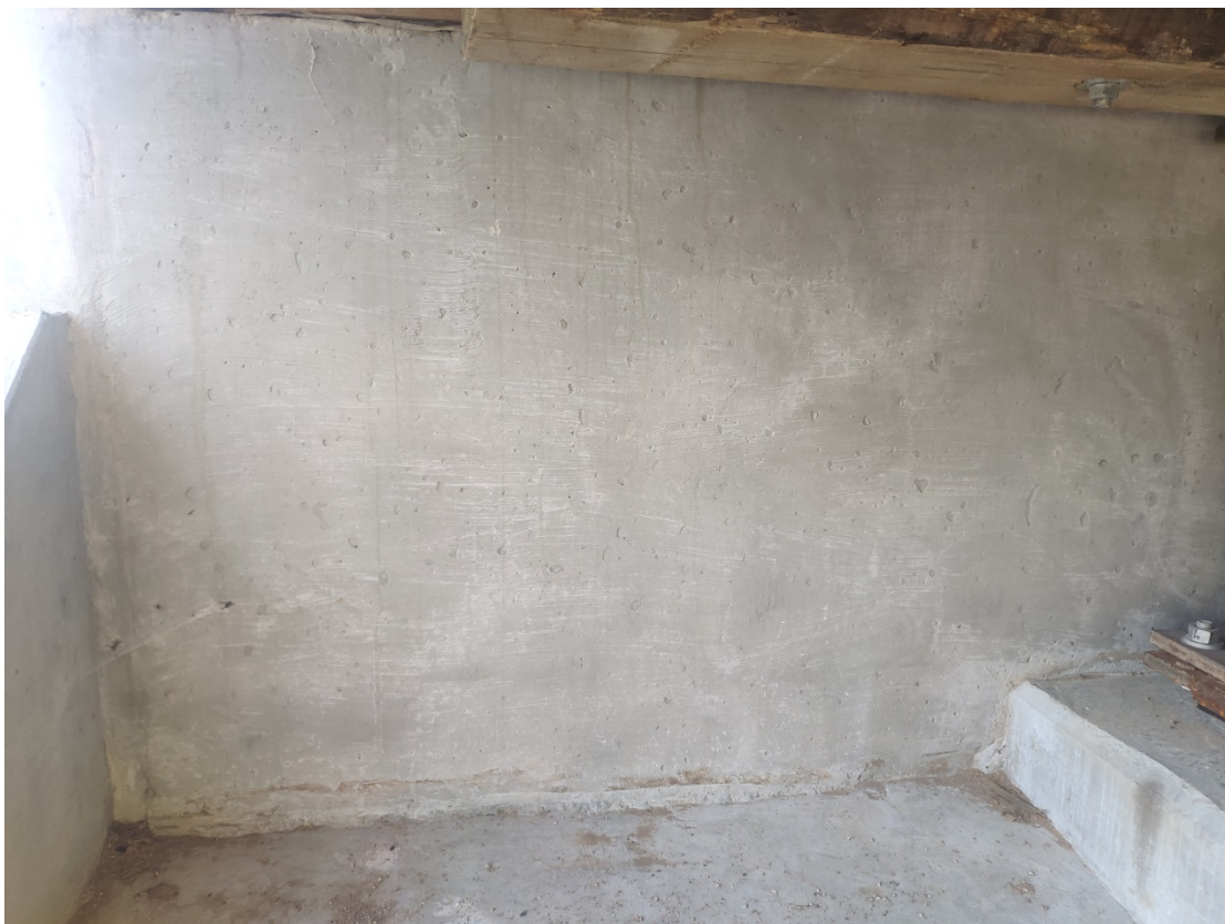
Рисунок Б3 – Раковины в бетоне шкафной стенки опоры №1
