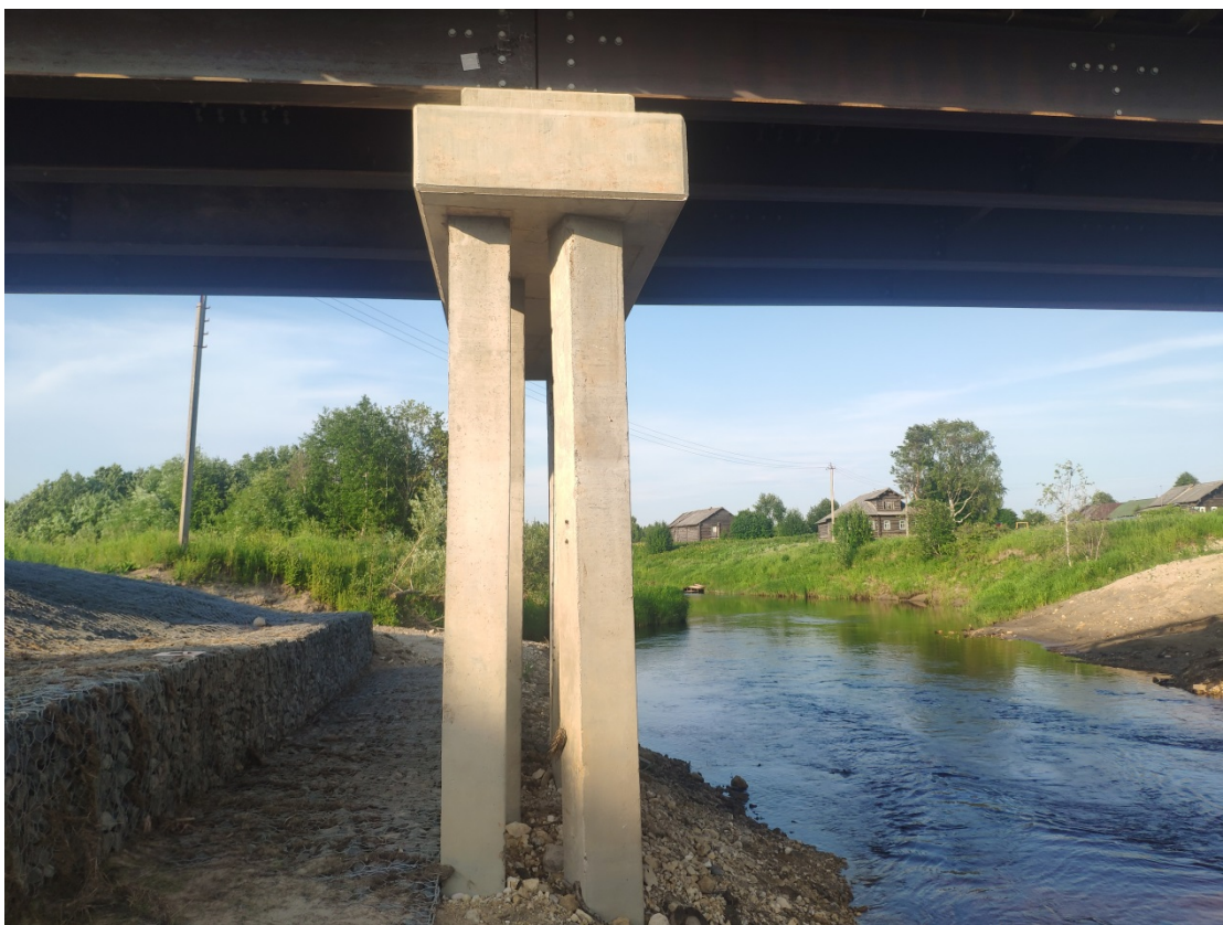
Рисунок Б8 – Смещение по вертикальной оси и в плане стоек опоры №2
