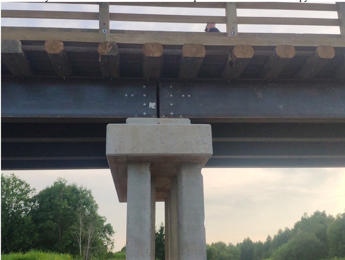
Рисунок Б2 – Смещение балок пролетного строения №2
