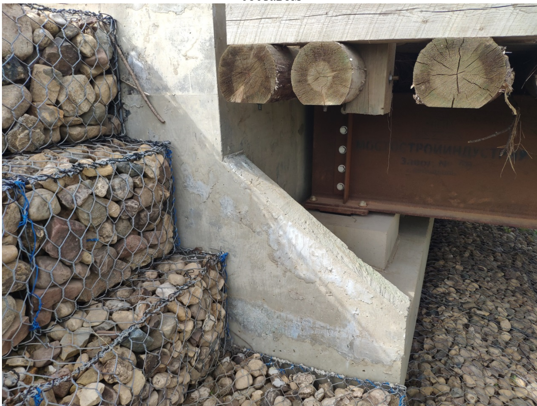
Рисунок Б24 – Раковины на левом открылке опоры №2, грубая обработка ремонтным составом
