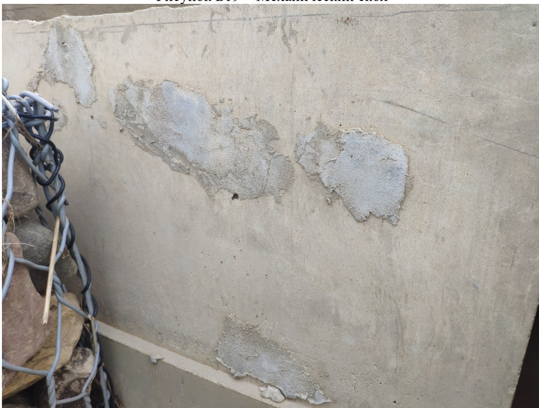
Рисунок Б20 – Раковины на правом открылке опоры №1, грубая обработка ремонтным составом
