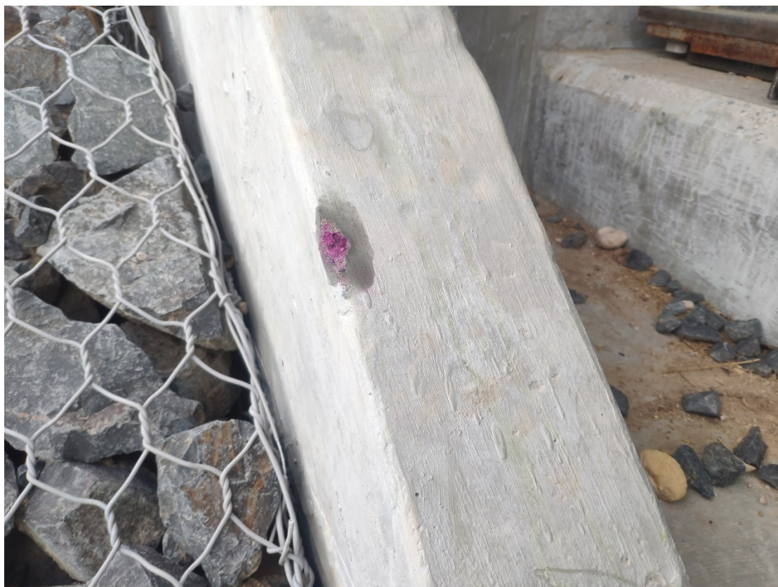
Рисунок 28. Проверка карбонизации на открылке опоры №1
