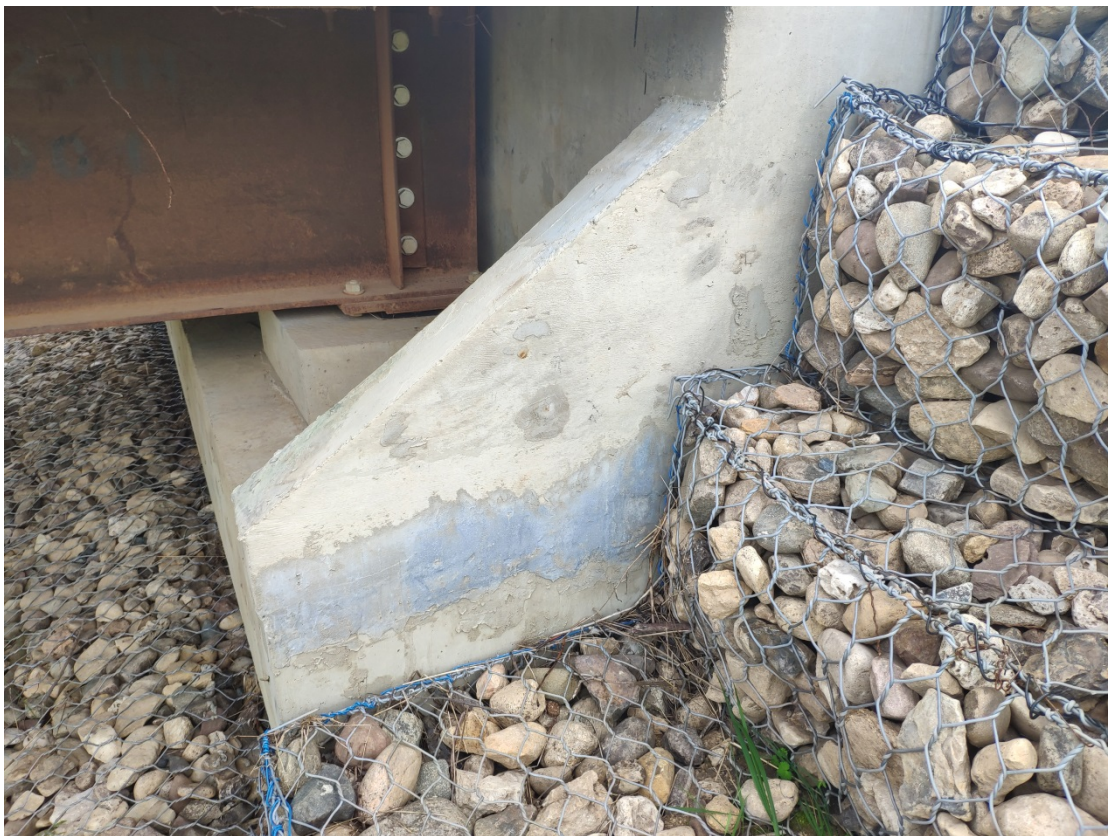
Рисунок Б23 – Раковины на правом открылке опоры №2, грубая обработка ремонтным составом
