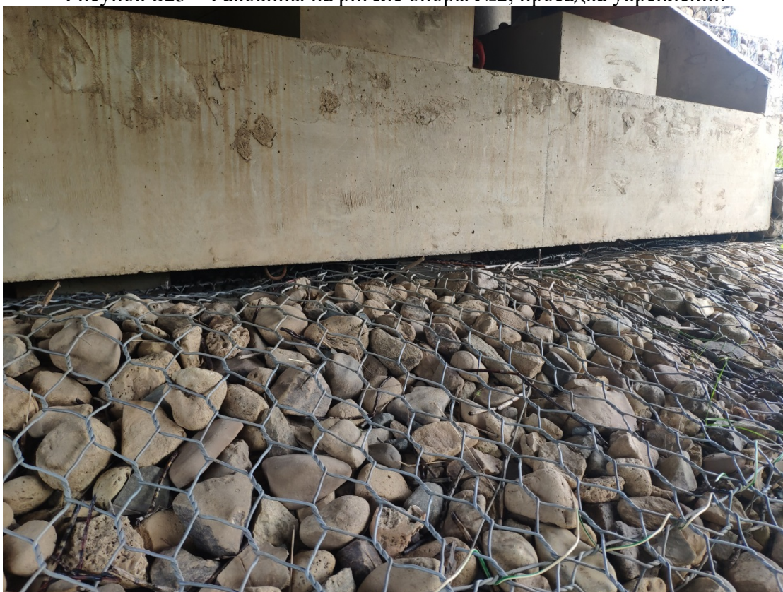
Рисунок Б26 –Просадка укреплений, опора №2
