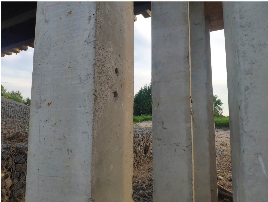
Рисунок Б5 – Раковины в бетоне стоек опоры №3
