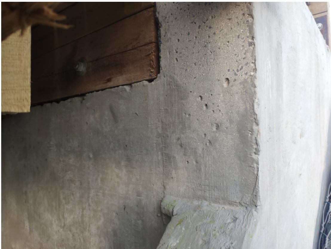
Рисунок Б11 – Раковины на бетонной поверхности шкафной стенки опоры №4
