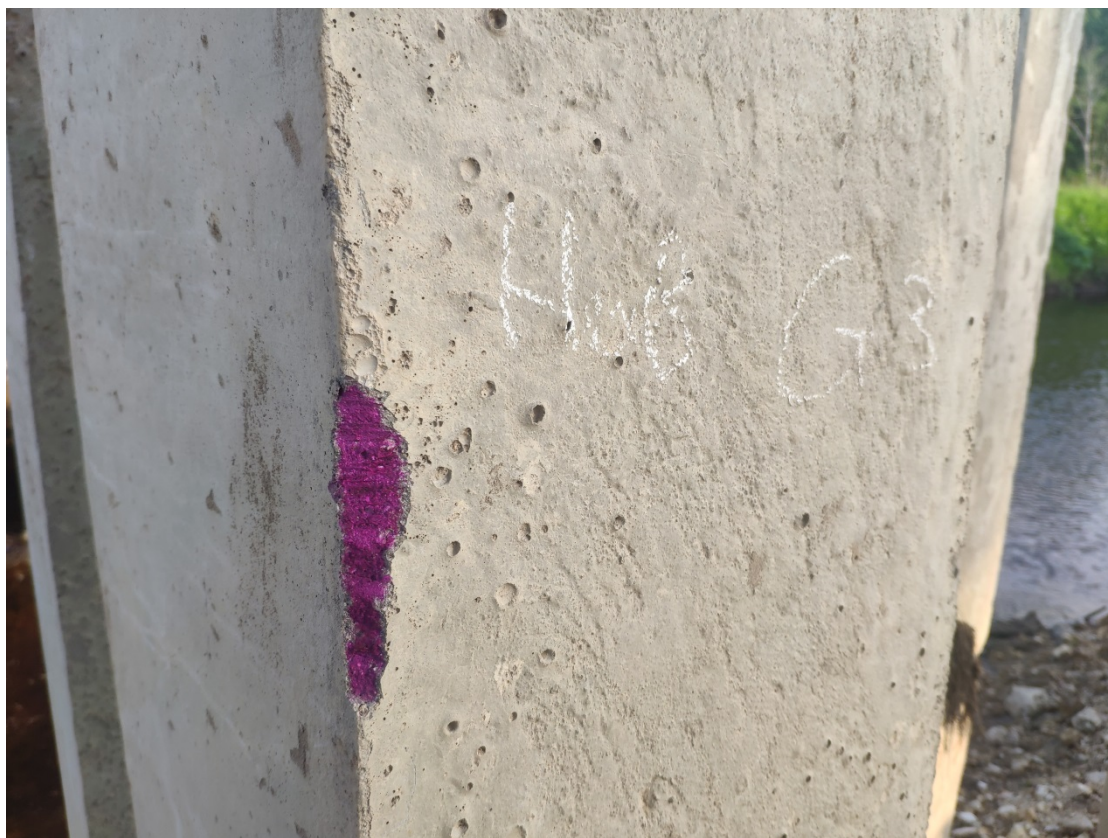
Рисунок 24. Проверка карбонизации на стойке №3 опоры №3
