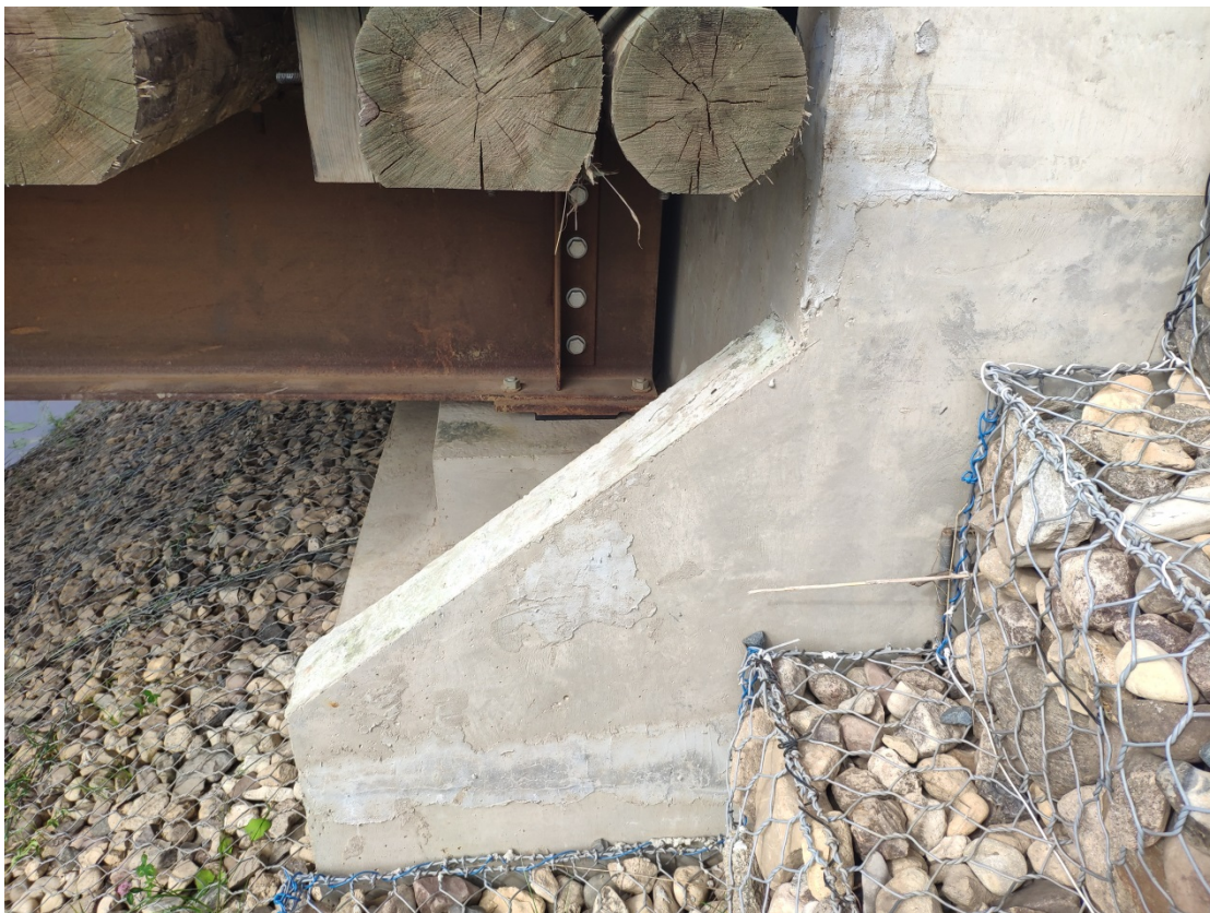
Рисунок Б21 – Раковины на левом открылке опоры №1, грубая обработка ремонтным составом
