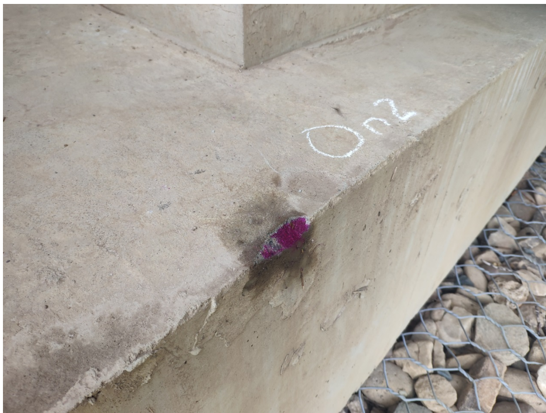
Рисунок 33. Проверка карбонизации на ригеле опоры №2
