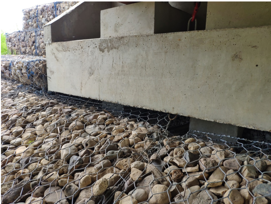
Рисунок Б25 – Раковины на ригеле опоры №2, просадка укреплений
