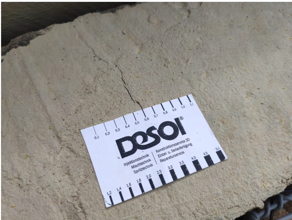
Рисунок Б22 – Технологическая трещина на правом открылке опоры №2
